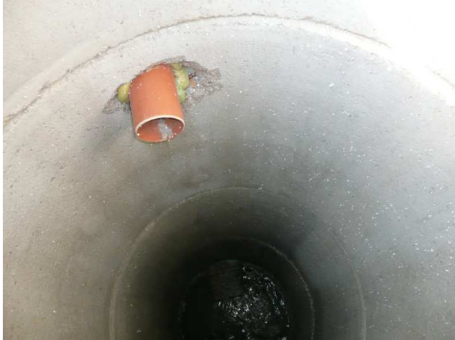
Abb. 3.6: Unplanmäßige Entsorgung von Regenwasser direkt ins Grundwasser im Neubaugebiet 171/1.
