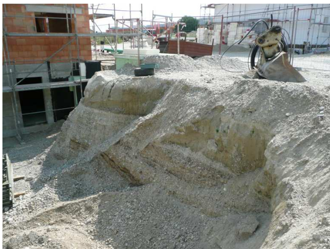
Abb. 3.8: schluffige Kiesschicht nach Abtragung des Oberbodens und Baugrube
